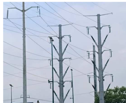
Figura 6. Aplicación del sistema de 115 kV en la modernización de subestación sustituida por subestación blindada de 400 kV.
